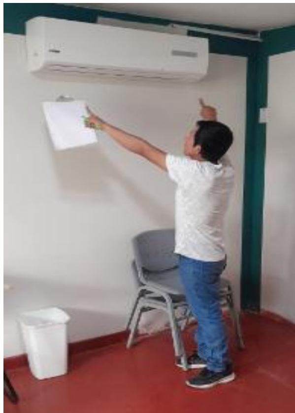
Nota. Unidad interior del aire acondicionado (Evaporador)
