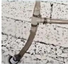
5. Trampa de condensados
